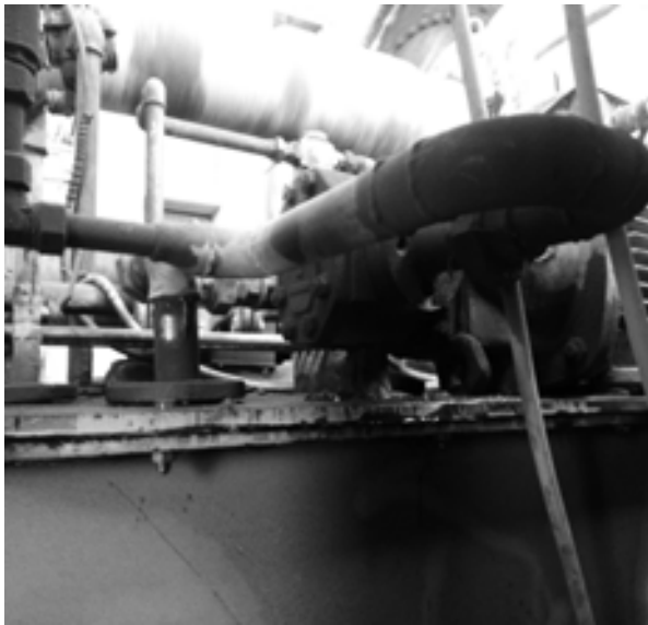
شکل ۶- وجود زانویی در مسیر فشار پمپ که باعث افت فشار می‌شود.
